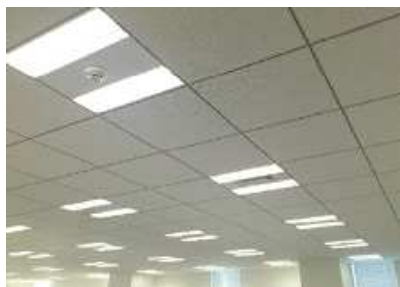
【室内LED照明】
