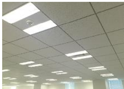
【室内LED照明】
