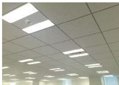
【室内LED照明】
