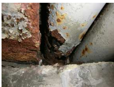
【塗装後10年程度で橋台際が腐食し、折損脱落した橋梁添架管路】
